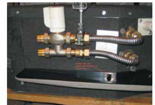
Поддон для сбора конденсата (внешний) и запорно-регулирующий узел смонтированы на кассетном фанкойле
