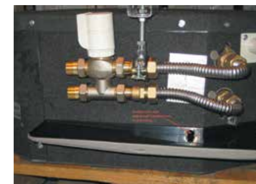
Поддон для сбора конденсата (внешний) и запорно-регулирующий узел смонтированы на кассетном фанкойле.
